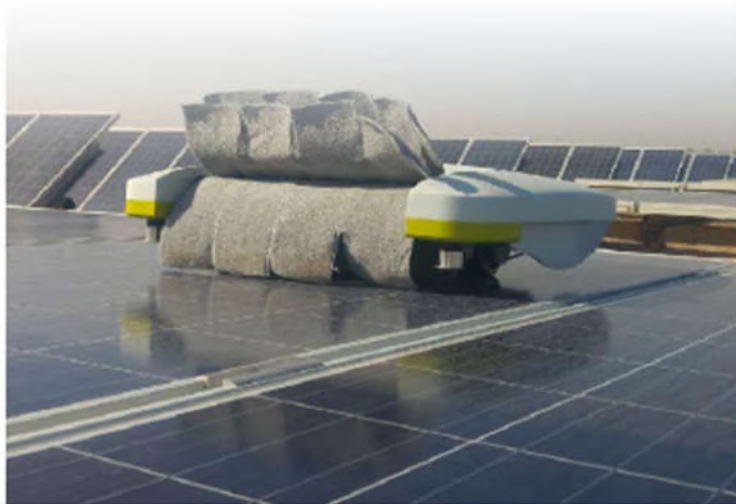
Figura 11 –robot per pulizia moduli fotovoltaici
