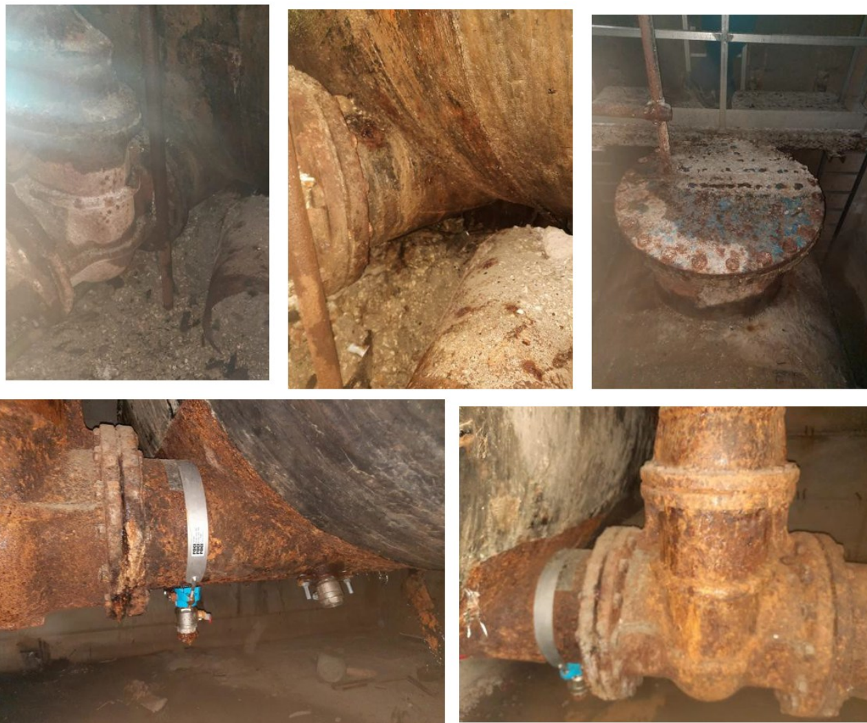
Figura 2: Foto durante i sopralluoghi con individuazione dello stato critico condotta nei manufatti
