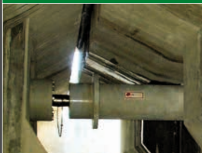
Un dissipatore viscoso ricentrante installato nel Rio Higuamo Bridge (Repubblica Dominicana).
