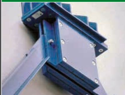
Un dissipatore EVED installato nella scuola Gentile-Fermi di Fabriano.
