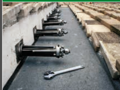
Dispositivi SMAD installati nella Basilica di San Francesco ad Assisi.
