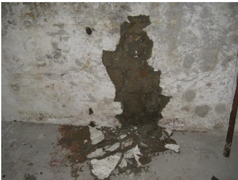
Fig.2 – particolare setto murario con intonaci ammalorati nei piani cantinato
