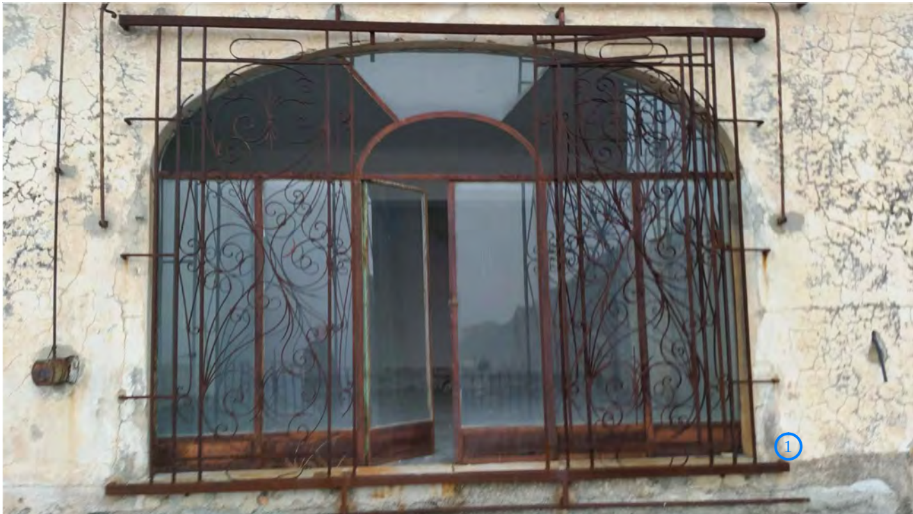
Fig.03. Foto terrazza, particolare inferriata
