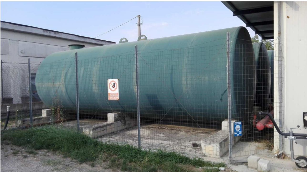
FOTO 17 - Sistema riserva idrica antincendio composto da n°3 serbatoi orizzontali da 30 mc cadauno.
