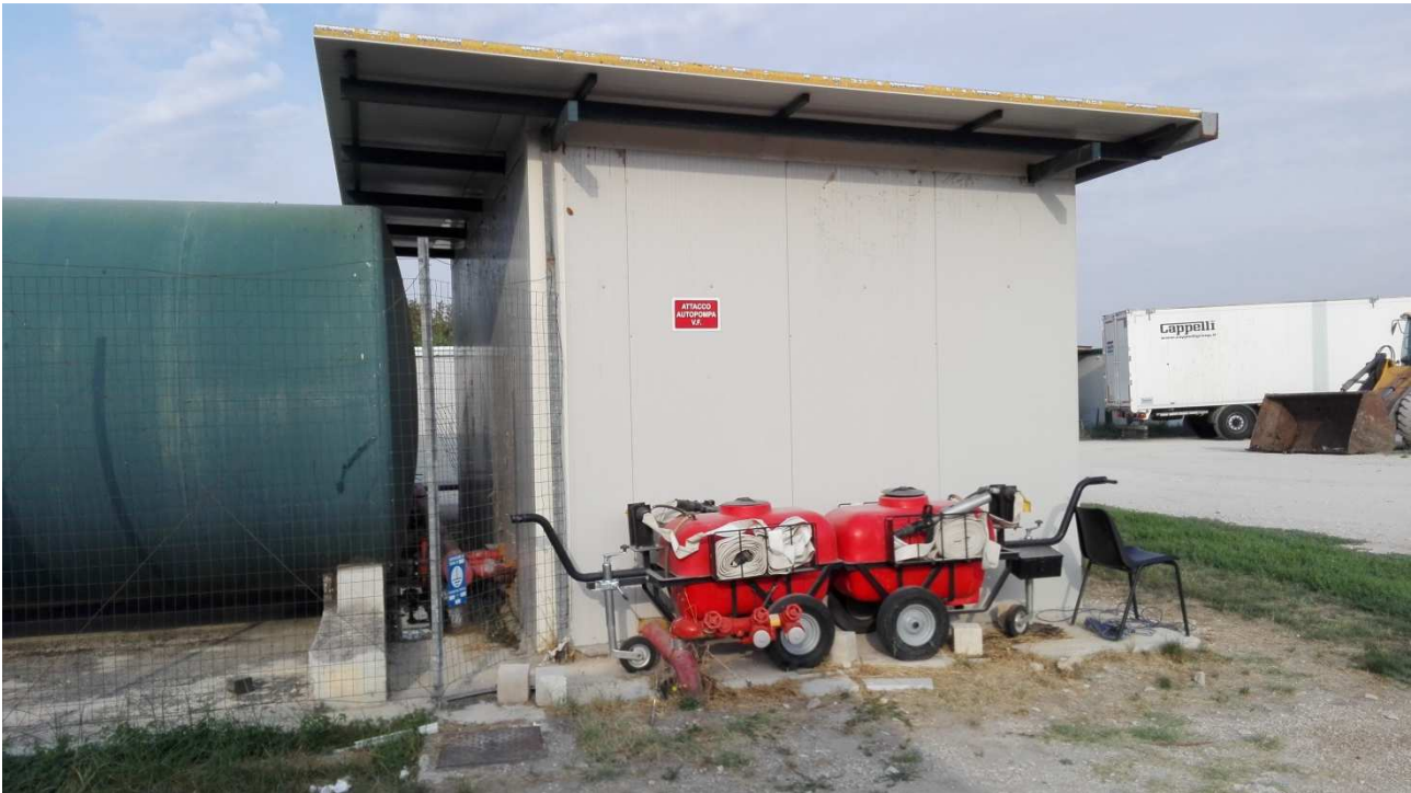
FOTO 16 - Locale pompe antincendio
