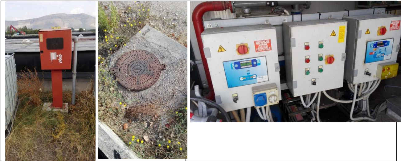
Figura 33 – Foto di alcuni impianti presenti in sito
