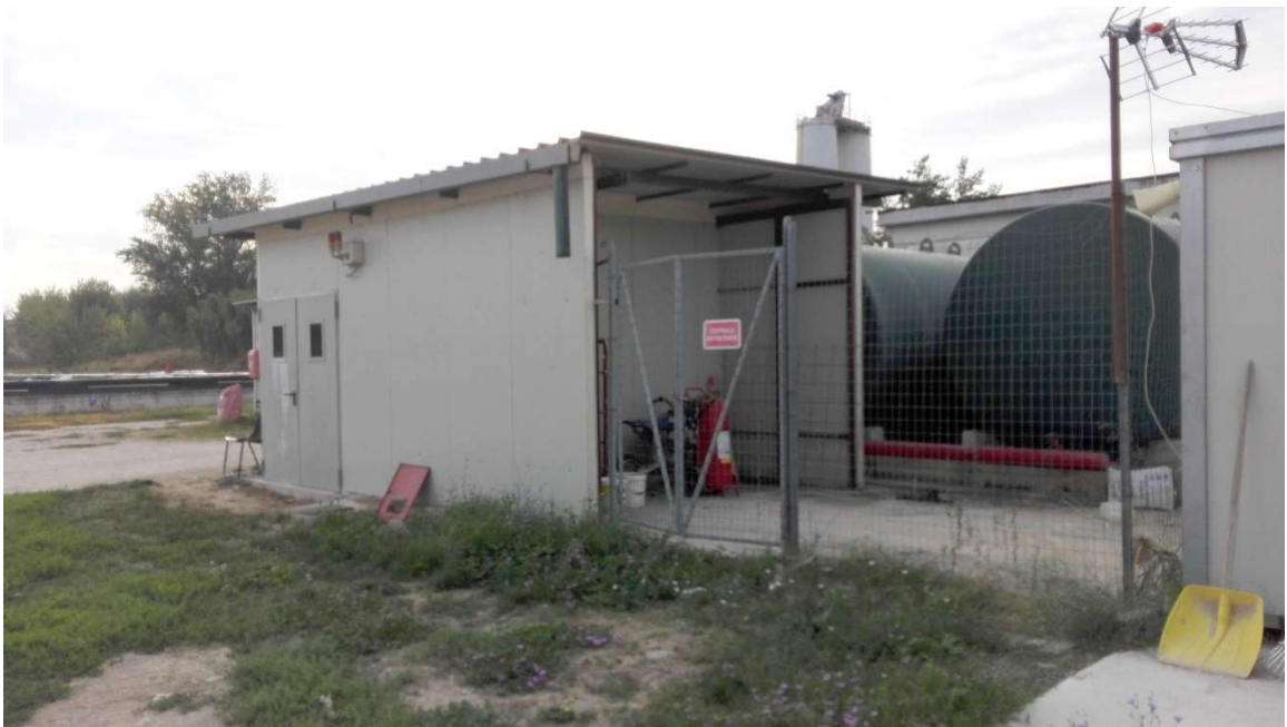
Figura 21 - Locale tecnico del gruppo antincendio – Container “A”
