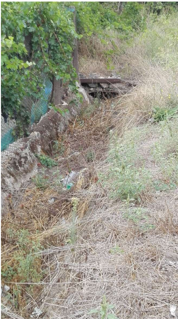
Figura 4 – Canale di raccolta delle acque meteoriche sulla strada di accesso al sito
