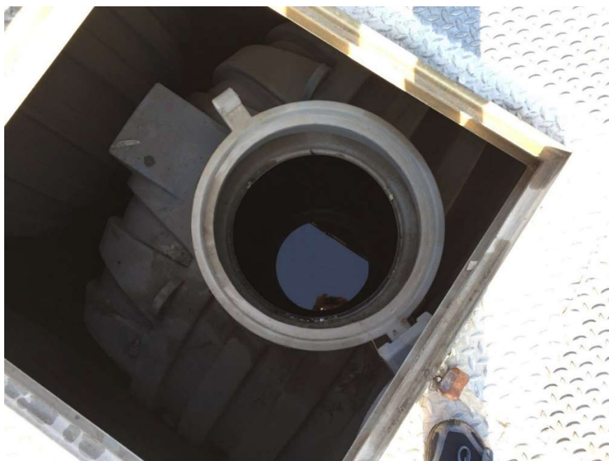
Figura 15 - Particolare della vasca del percolato.
