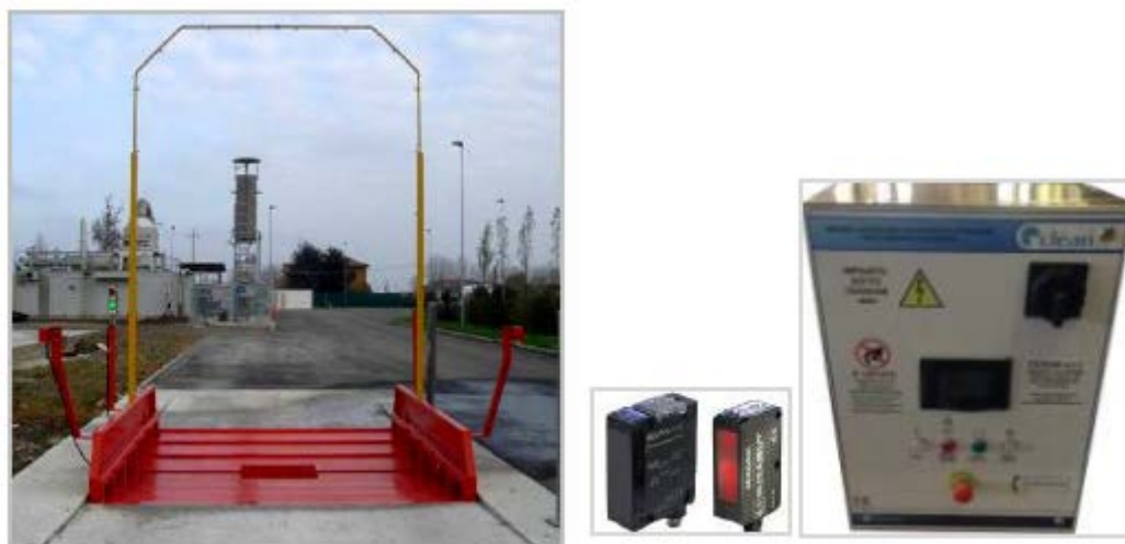
Figura 8 - Esempio tipo di lavaruote fisso e quadro elettrico
