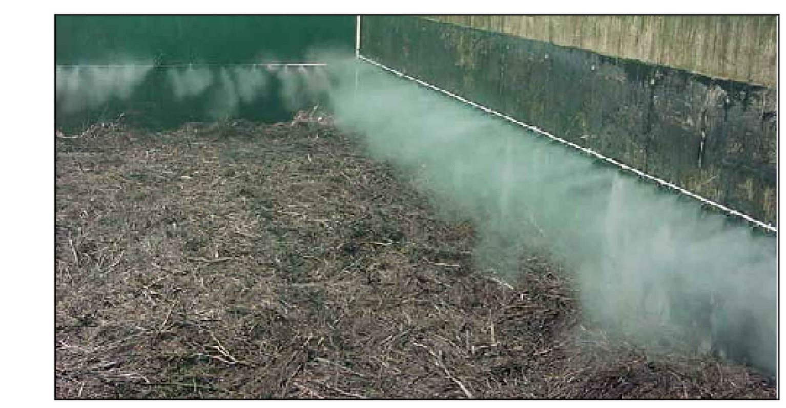
SISTEMA DI NEBULIZZAZIONE DEL BIOFILTRO
