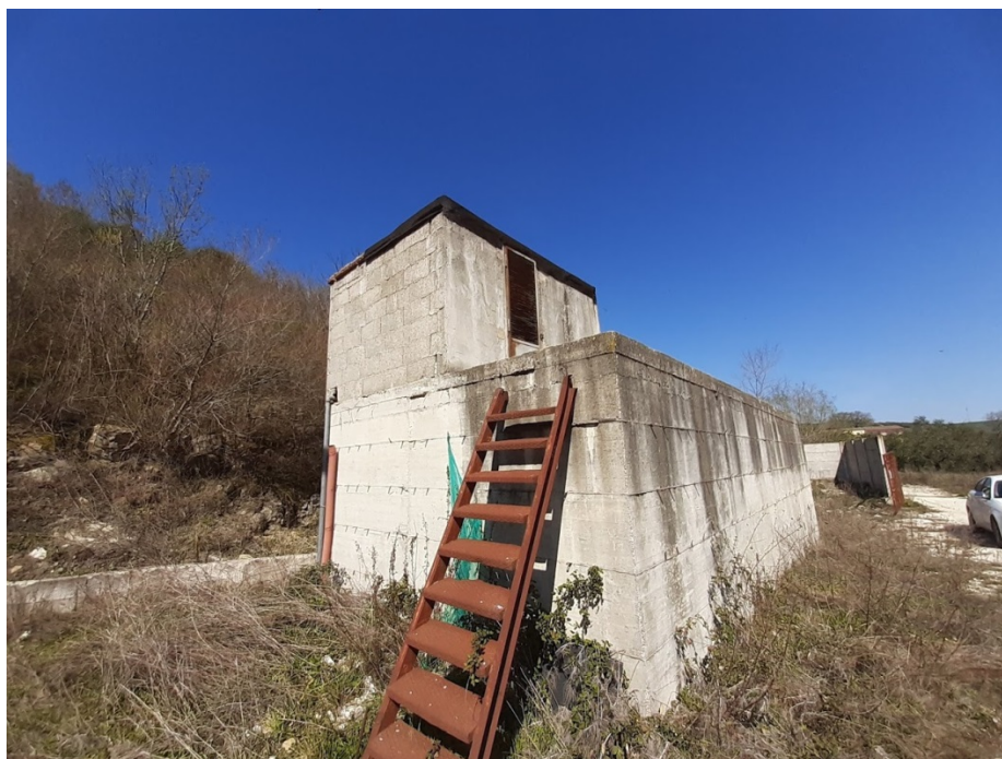
Foto 8: gruppo si pressurizzazione
