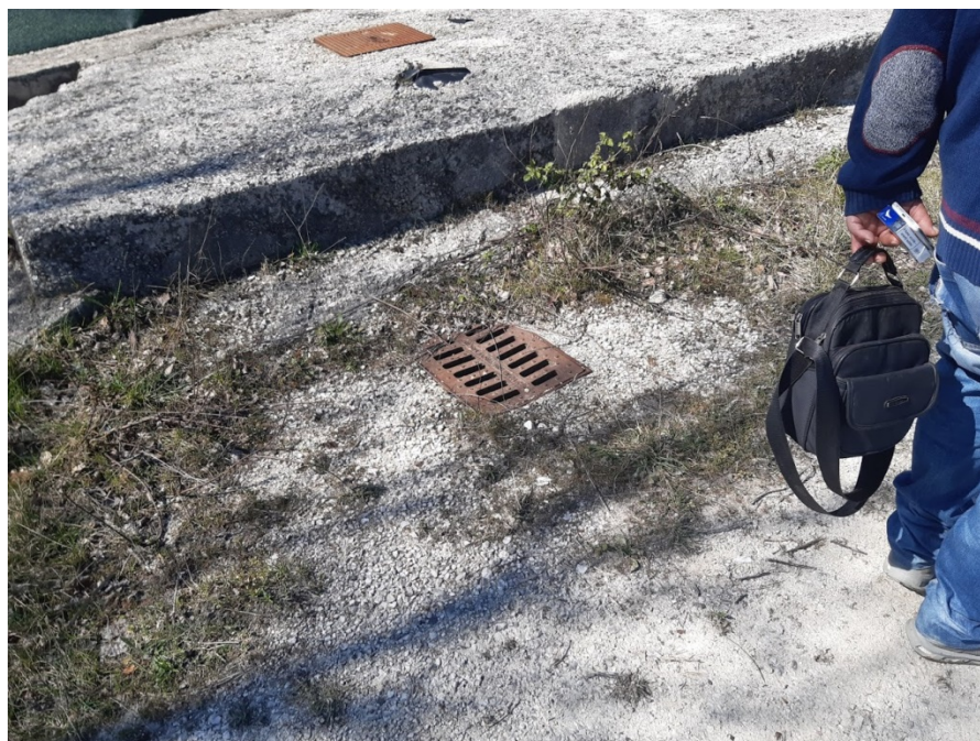
Foto 11: griglia di drenaggio acque meteoriche
