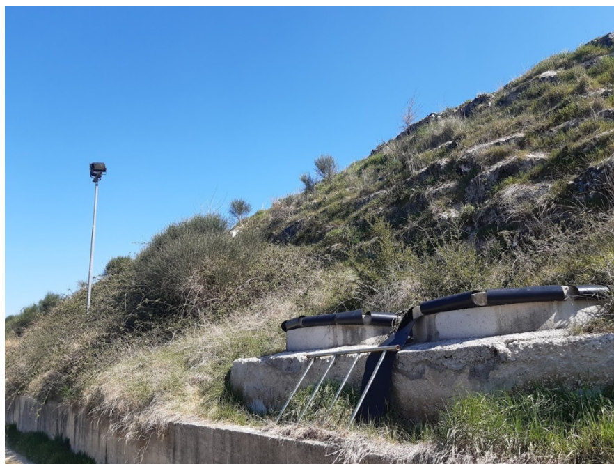
Foto 12: serbatoi stoccaggio percolato
