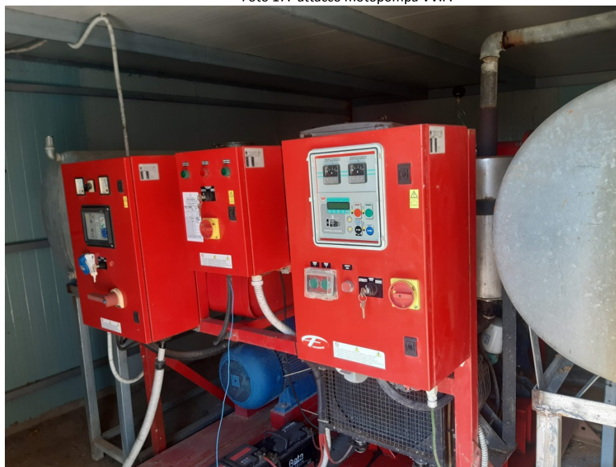
Foto 18: gruppo di pressurizzazione
