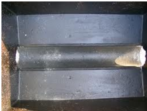
Pozzetto con superficie di scorrimento continua
